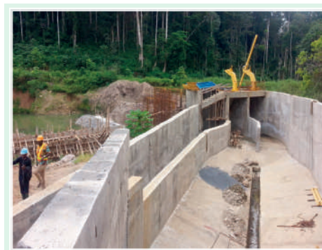
Projet d'électrification rurale décentralisée dans la région du Sud-ouest (zone RUMPI)
