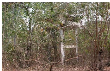
Photo 30 : Château d'eau abandonné par l'ANAFOR à la pépinière
