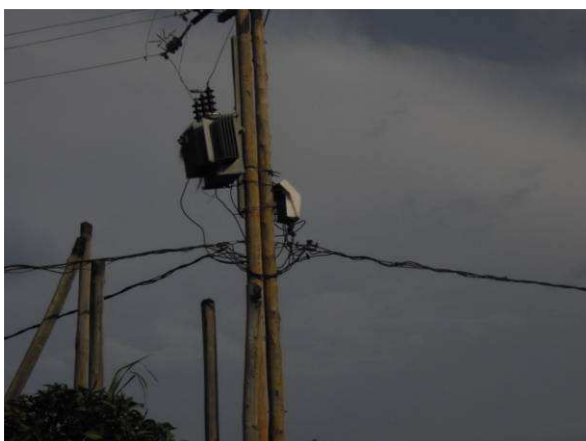
Photo 13: Un transformateur dans la zone urbaine de Nkolmetet.
